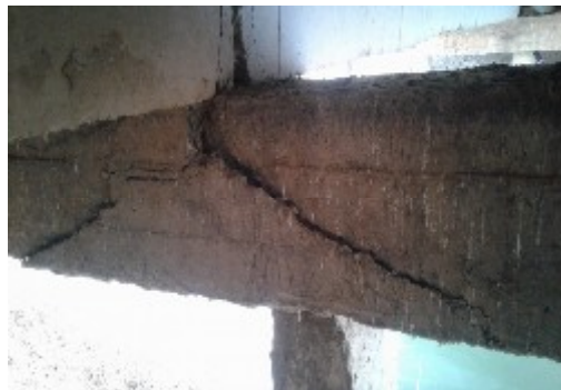
Рис. 3. Силовые трещины в насадке промежуточной опоры моста
