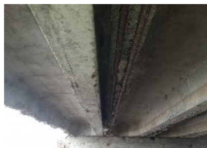
Рис. 2. Выпадение бетона защитного слоя П-образных плит пролетного строения по причине низкого качества бетонирования
