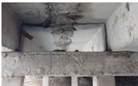
Рис. 1. Дефекты швов омоноличивания балок пролетного строения, возникшие по причине низкого качества использованной бетонной смеси
